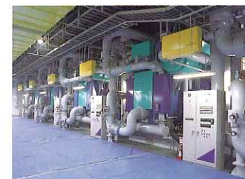
地域冷暖房システム
